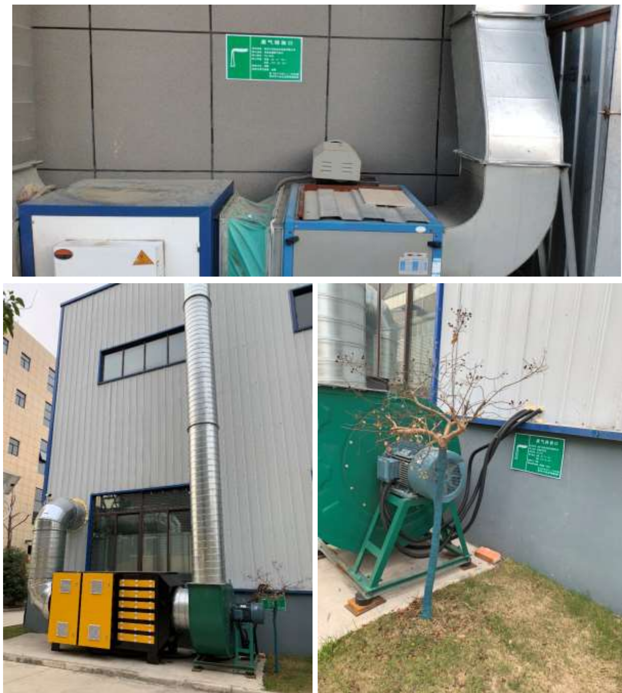
图 4-2 废气处理设施现场照片
