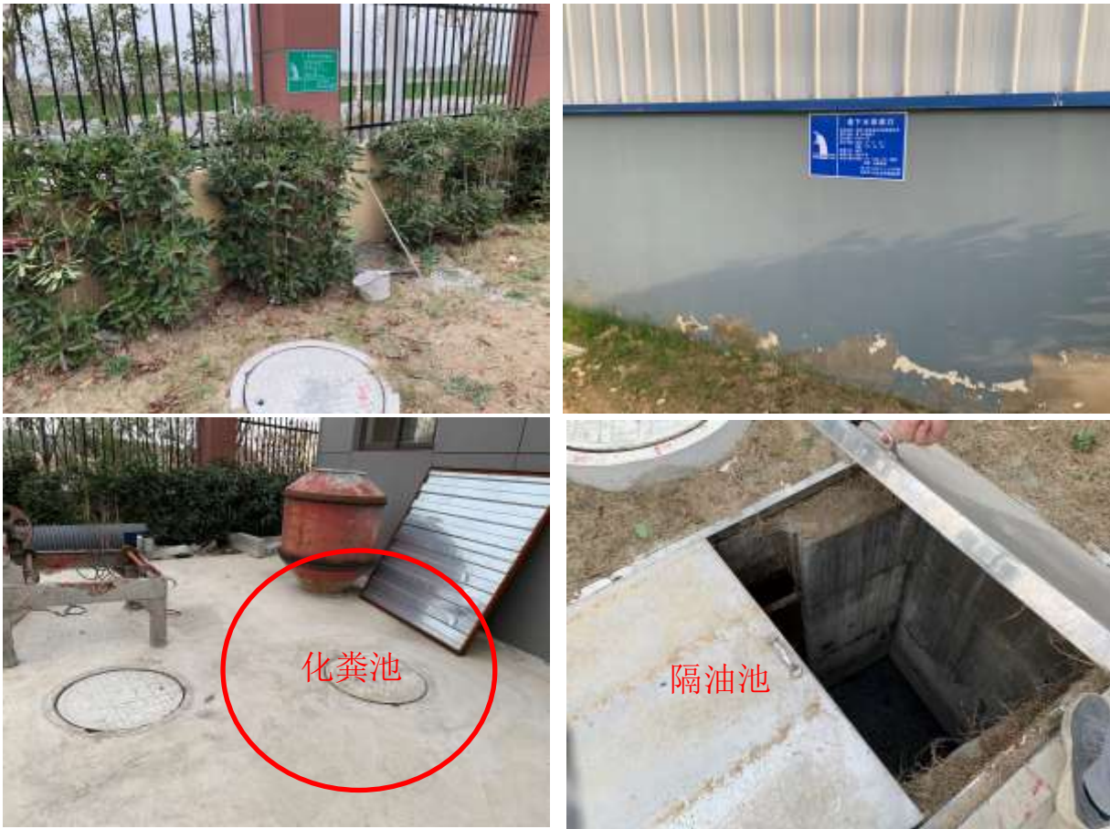
图 4-1 废水处理设施照片
