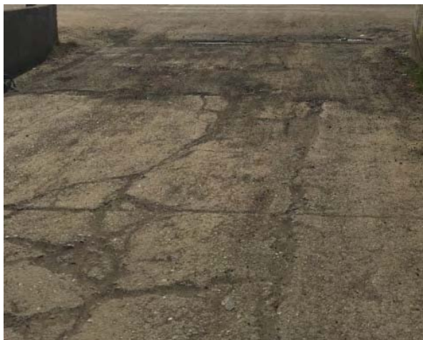
现状道破损严重
